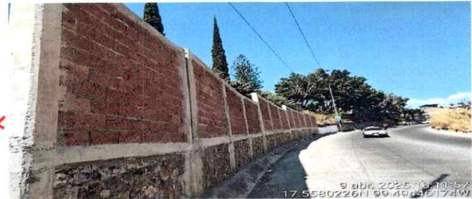
Concepto Revisado: Barda terminada en el lado de la carretera Terminado de la Aula de Usos Múltiples del Edificio "F"
